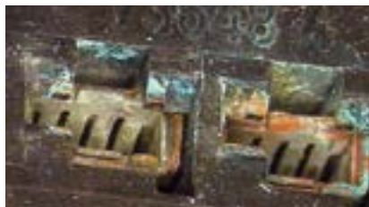
Złącze z wilgocią i śladami korozji
