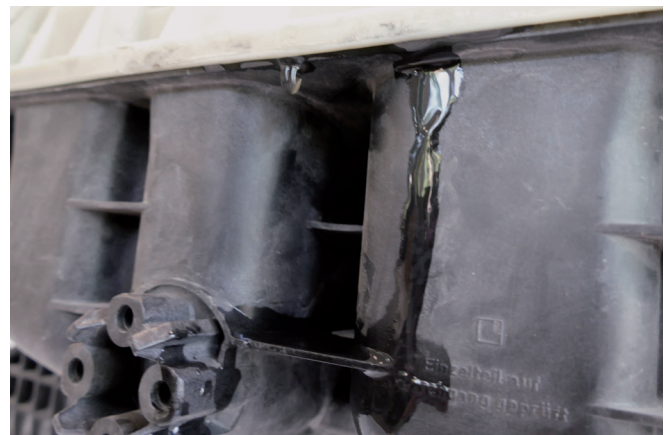
Εικόνα 3: Το υπερβάλλον ψυκτικό εξέρχεται ξανά στην περιοχή του διαχωριστικού αρμού στο δοχείο διαστολής
