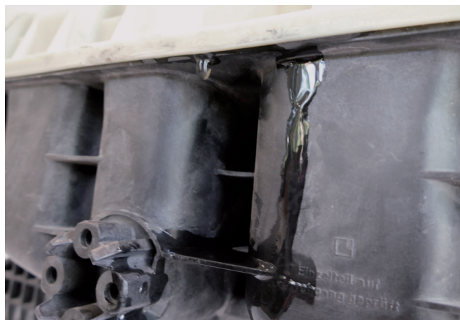
Zdjęcie 3: Wypływające chłodziwo wycieka w obszarze łączenia na zbiorniku wyrównawczym
