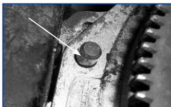
Kołki ustalające skrzynię (zniszczone lub ich brak)
